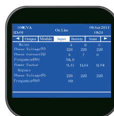
Контрольная панель шкафа ИБП
